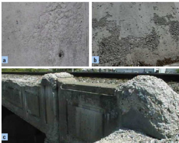
Figura 2a : Distacco della "pelle" del calcestruzzo;
